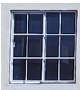
Protección en ventanas
